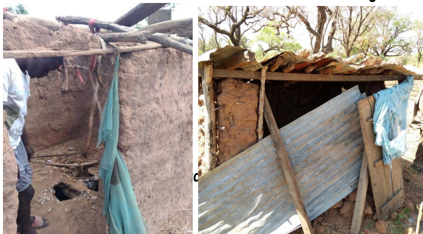
Photo 3 et 4 : des latrines abandonnées dans des villages REDAL
